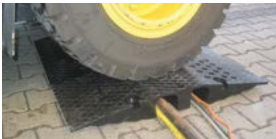
Detail: Schläuche/Kabel abgedeckt
